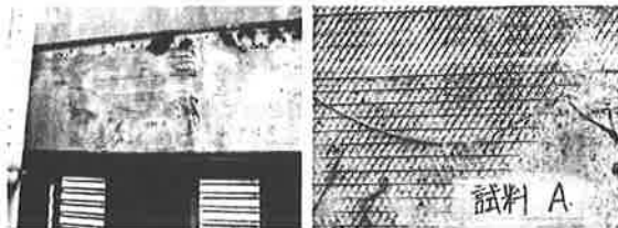
写真3 仕上げを施していない外壁の例
